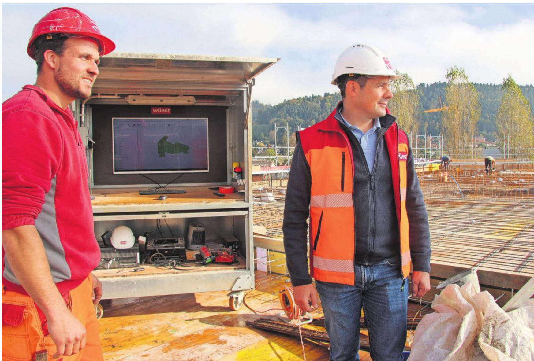
Auf der Baustelle in der Nebiker Vorstadt. Der via Bildschirm digital vorhandene Zwilling des realen Baus gib den Takt vor. Für Polier Tobias Kumschick (links) und Geschäftsleitungsmitglied Jan Peter vom Gesamtleistungsanbieter Wüest AG ist die sogenannte «BIM»-Methode erst der Anfang einer grossen Veränderung in ihrer Branche. Foto Stefan Bossart
